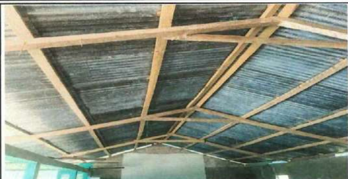
Foto 1: Se observa la necesidad de la sustitucion de la estructura de soporte de madera por metal
