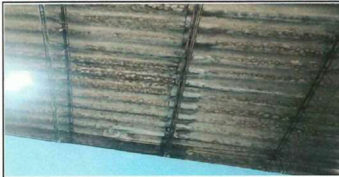
Foto 4: Se observa la necesidad de la sustitucion de lamina, por lamina troquelada
