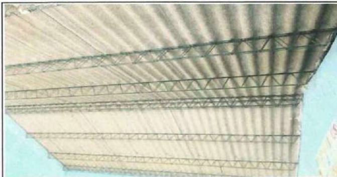
Foto 2: Se observa la necesidad de la sustitucion de la estructura de soporte de metal por metal
